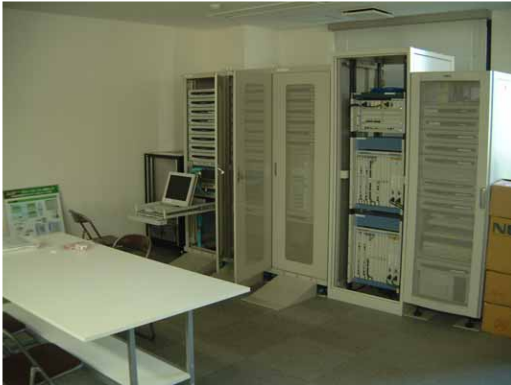
名古屋事務内センタ設備
