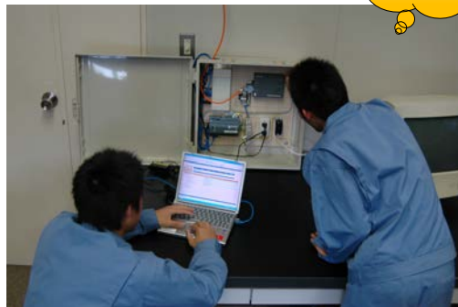
教室の照明の制御、温度等センサ情報 の取得 (広島市立広島工業高校)
